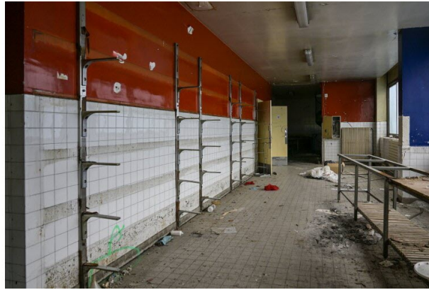
Au rez-de-chaussée, l'intérieur du Chalet du Parc s'est abîmé. Photo Maxime Jegat
